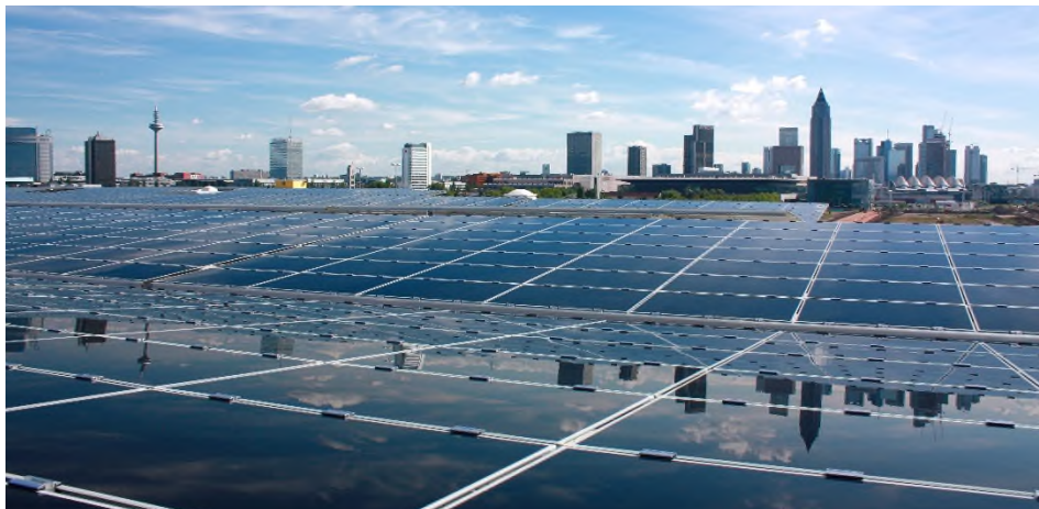
Sonnenkollektoren auf dem Rebstock-Parkhaus – eine der drei Photovoltaikanlagen der Messe Frankfurt.
